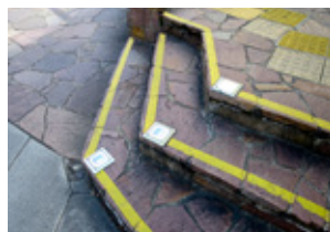
対応事例（段鼻に黄色の反射テープを設置）
