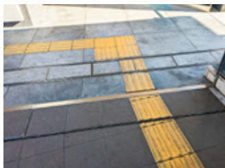
連続性に配慮した視覚障害者誘導用ブロックの敷設
